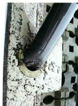
1本目のひび割れ状況
