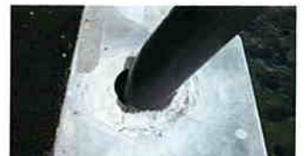
縦断方から見た支柱の変位状況
