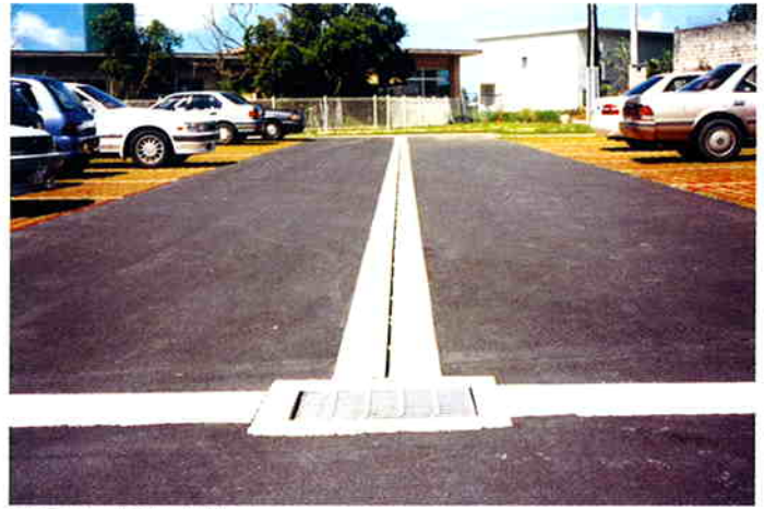
マルチスリット側溝 N型
